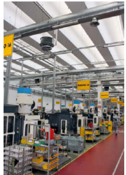
In der Brembo Motorradabteilung sind von AR Filtrazioni hergestellte Filtertypen der Serien Arno und Eco installiert.
