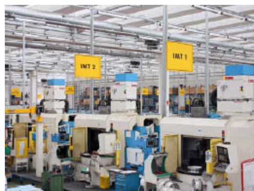
Die AR Filtrazioni hat in der Brembo Sektion Motorrad in Curno (Bergamo) ein artikuliertes Luftreinigungs-system installiert.
