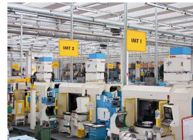
La AR Filtrazioni ha installato un articolato sistema di impianti di aspirazione e depurazione dell'aria presso il reparto moto della Brembo a Curno (BG)
