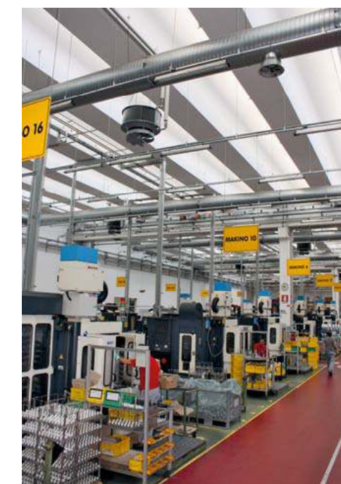
Presso il reparto Moto della Brembo sono installate due tipologie di filtri della serie Arno e della serie Eco realizzati da AR Filtrazioni
