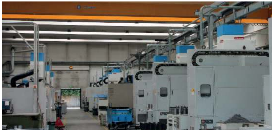
Se guardiamo agli impianti installati in Lonati, la sostituzione dei filtri è avvenuta dopo circa un anno e mezzo dall'installazione
